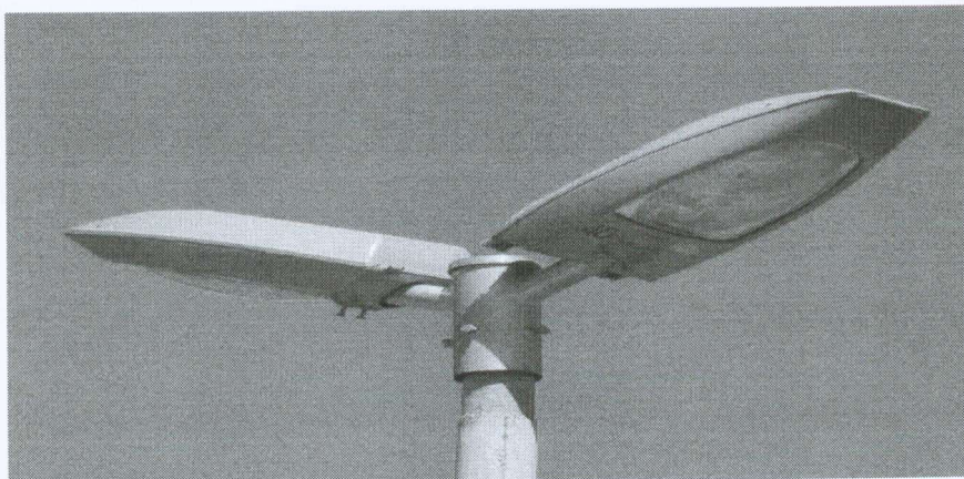
CONJUNTO C/02 PÉTALAS E LÂMPADAS VAPOR METÁLICO 400W, MONTADA EM POSTE DE CONCRETO CIRCULAR - H=12M
