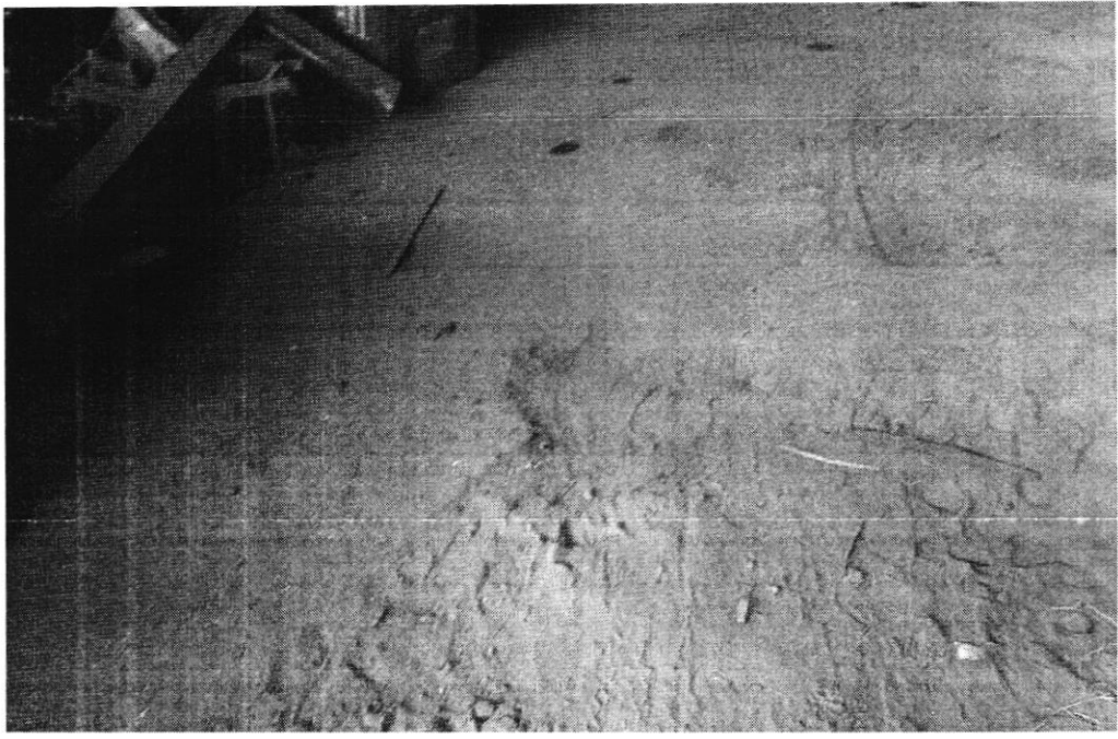
FOTO 12 - DETALHE DO ESTADO DO PISO NO SALÃO PRINCIPAL QUE ABRIGARÁ O SETOR DE PRODUÇÃO.
